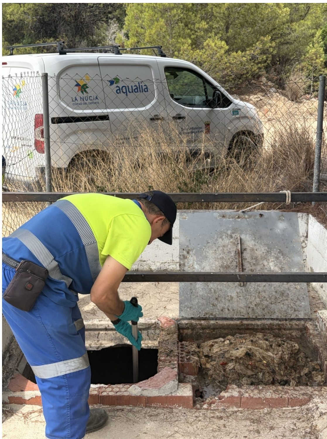
Un operario de la empresa Aqualia elimina toallitas de la red. Foto: AQUALIA
